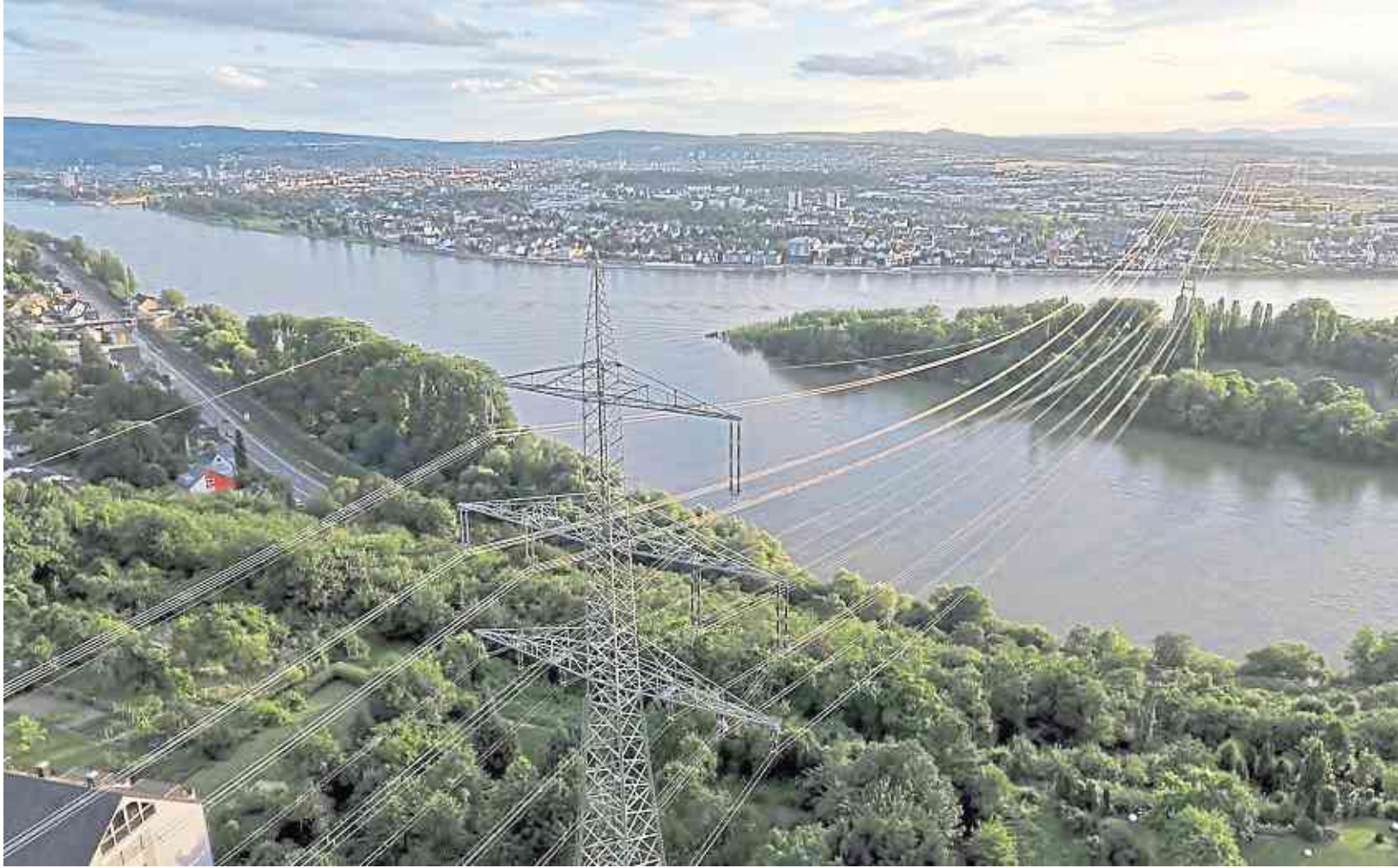
Fast idyllisch wirkt auf diesem Foto die Stromtrasse über den Rhein bei Urbar. Doch der Schein trügt: Die im Zuge des Ultranetprojektes geplante Umrüstung der Stromleitungen, die zukünftig Gleich- und Wechselstrom übertragen sollen, steht in der Kritik.
